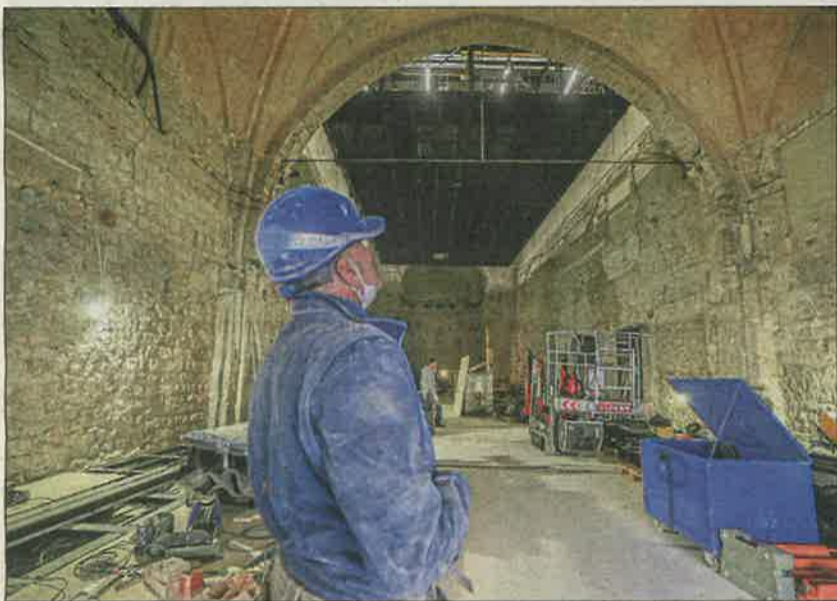
Le chantier de l'église des Franciscains se poursuit avec, comme date butoir, le 26 avril. Date de la première du TNN. (Photo Sébastien Botella)
